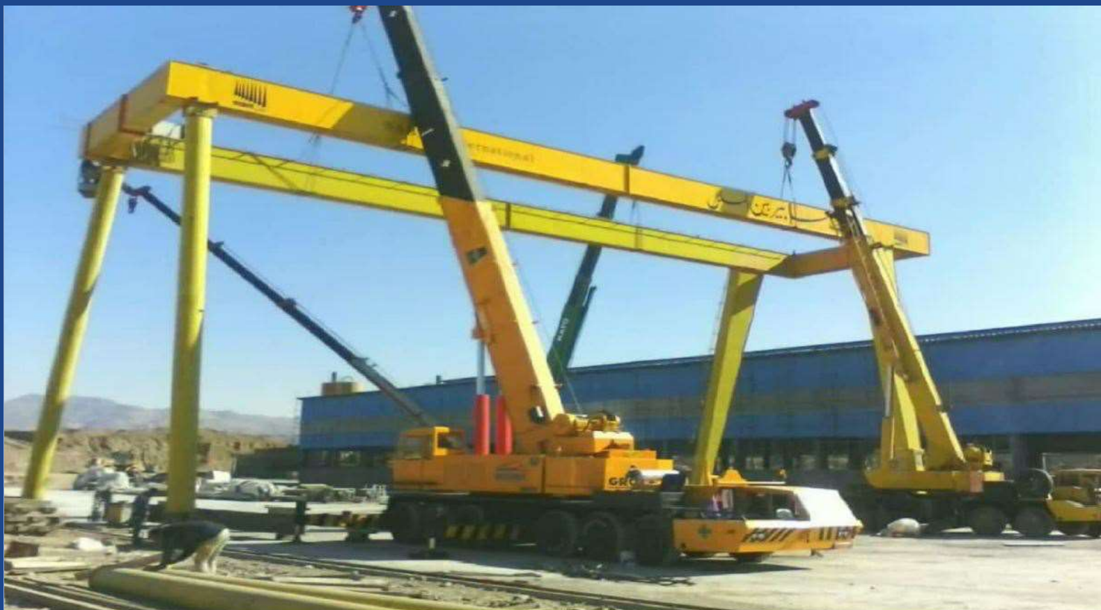
جرثقیل دروازه ای ۲۵ تن با دهانه ۳۰ متر شرکت سابیر بین الملل پروژه خط ۶ مترو
